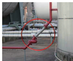
Flexible joint 소방배관
